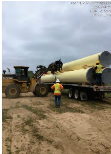
Seg A – Unloading Pipe
