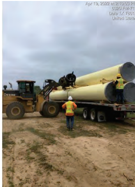
Seg A – Unloading Pipe
