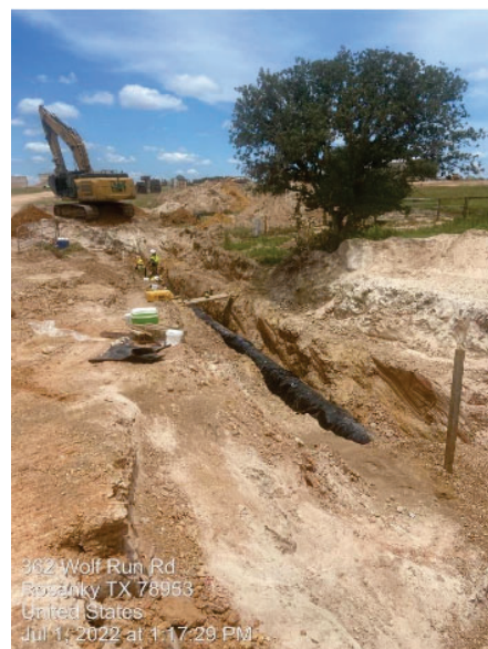
WTP– Raw Waterline WL-A
