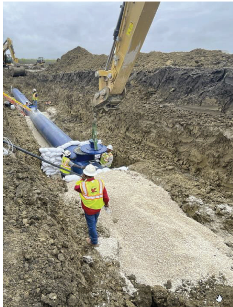
Seg D – Manhole Lid for Valve
